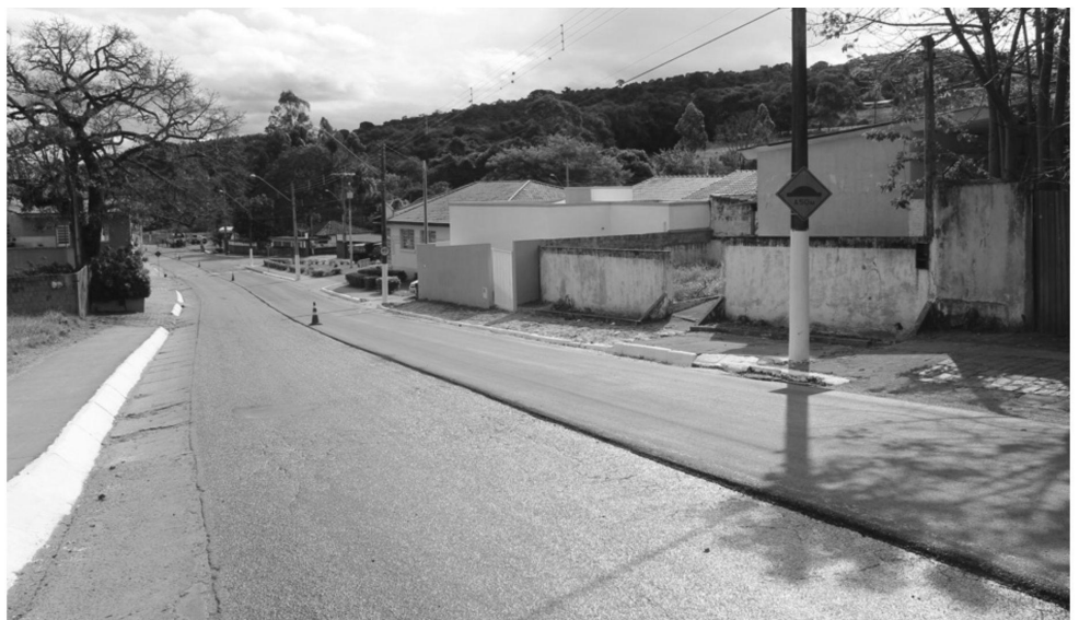
A Via Paulo Ferreira, principal acesso à entrada e saída de Itararé ao Paraná, está em obras há cerca de um mês.
